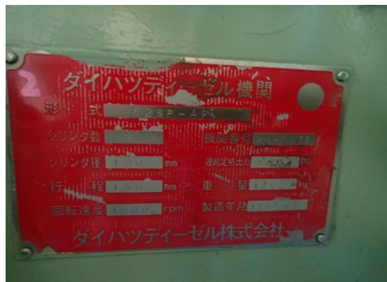
銘板 (現地確認)
