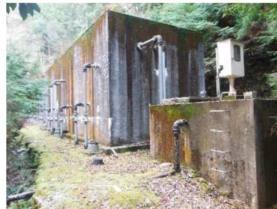
図 2-6 中央浄水場(美郷中央浄水場)
