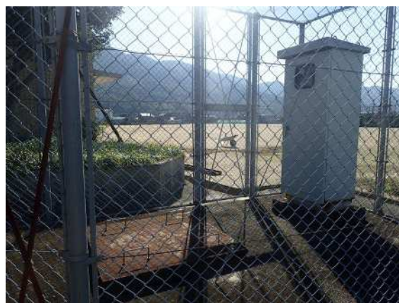
図 2-2 川島町取水井(3号井)
