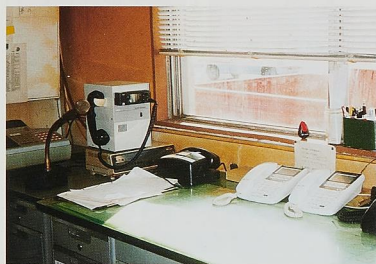
通信室 (中消防しょ)
