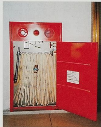
消火せんの内 部
