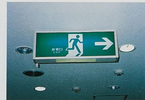
避難口誘導灯
