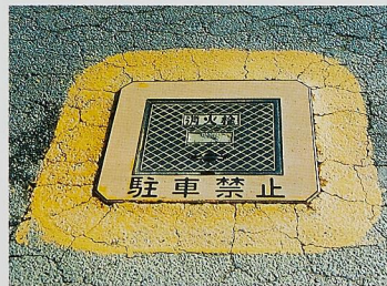
道路の消火せん
