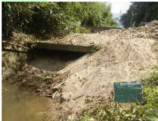
土砂が堆積した水路
