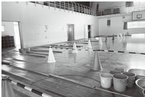
雨漏りにより体育館の床が損傷している
