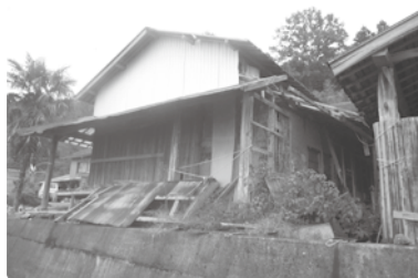
老朽危険空き家（撤去前）
