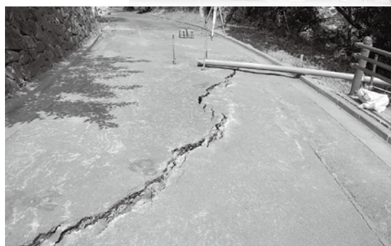
園路東側クラックの状況
