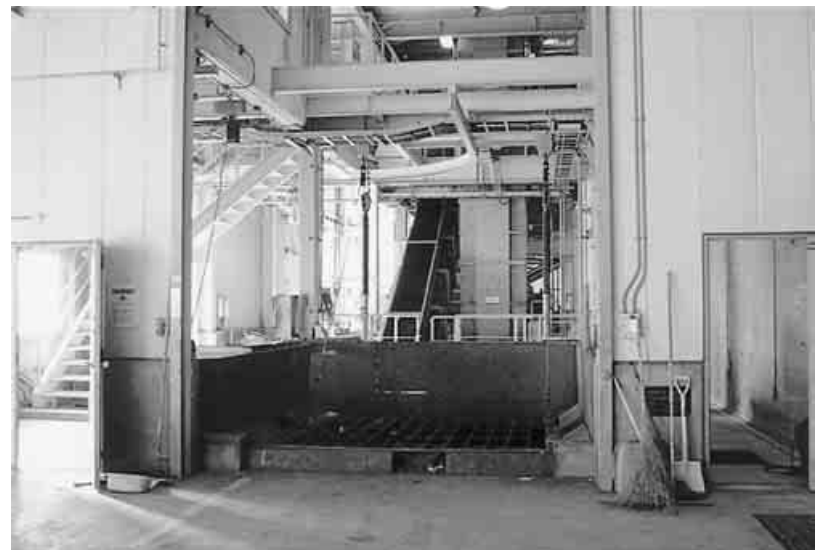
川島美化センター内部
