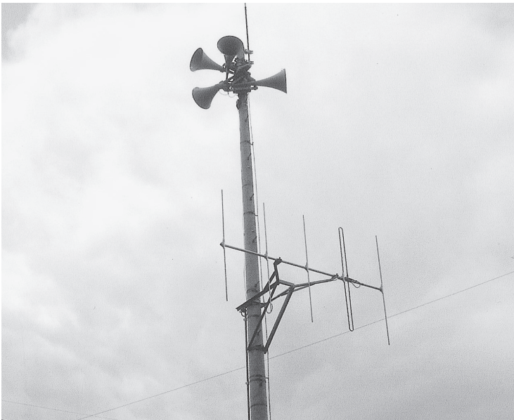
山川地区に設置されている防災無線
