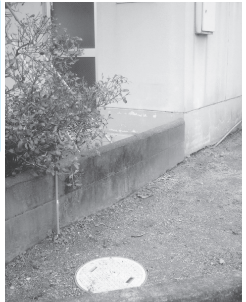
市営住宅の公共下水
