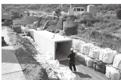
諏訪地区排水路整備状況
