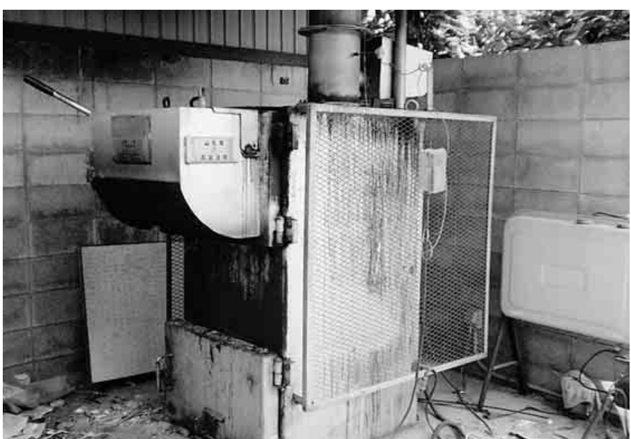
市内建設業者の焼却炉
